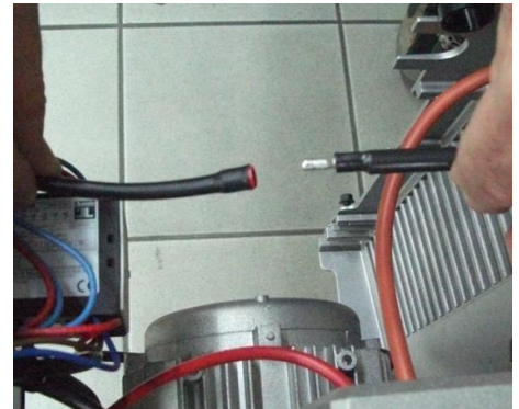
15) Подсоединить кабель электрода ионизации к разъему;
